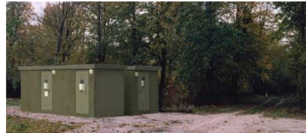
Photographie 58 : Image de référence d'un poste de livraison peint en vert dans un contexte rural et bocager similaire à celui du projet de Croix du Picq
